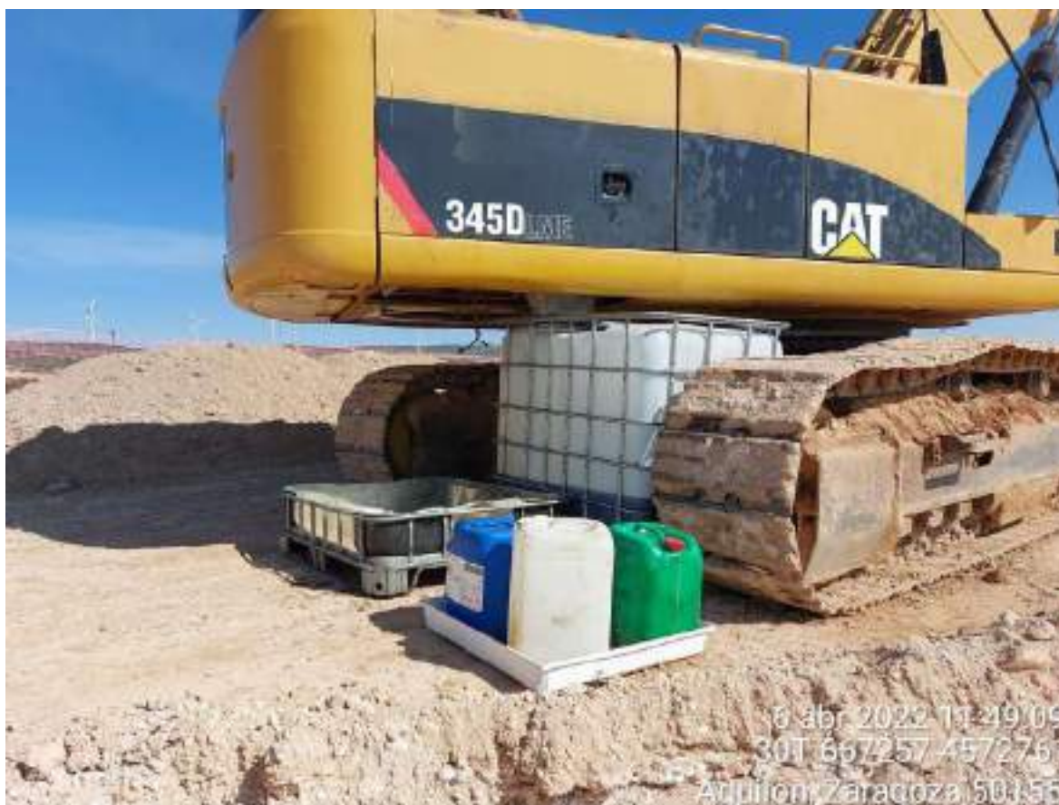
Imagen 5. Bidones colocados sobre cubetos de contención.
