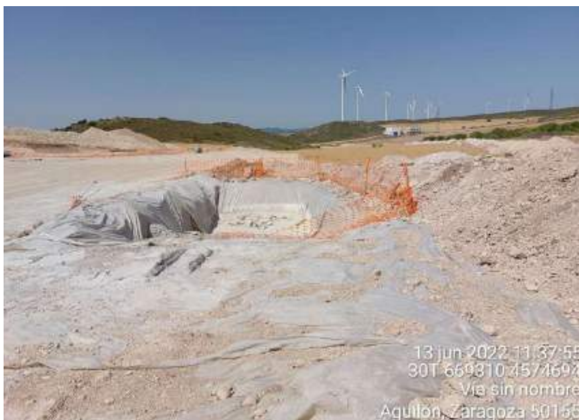
Imagen 1. Pozo de lavado utilizado en hormigonado.
