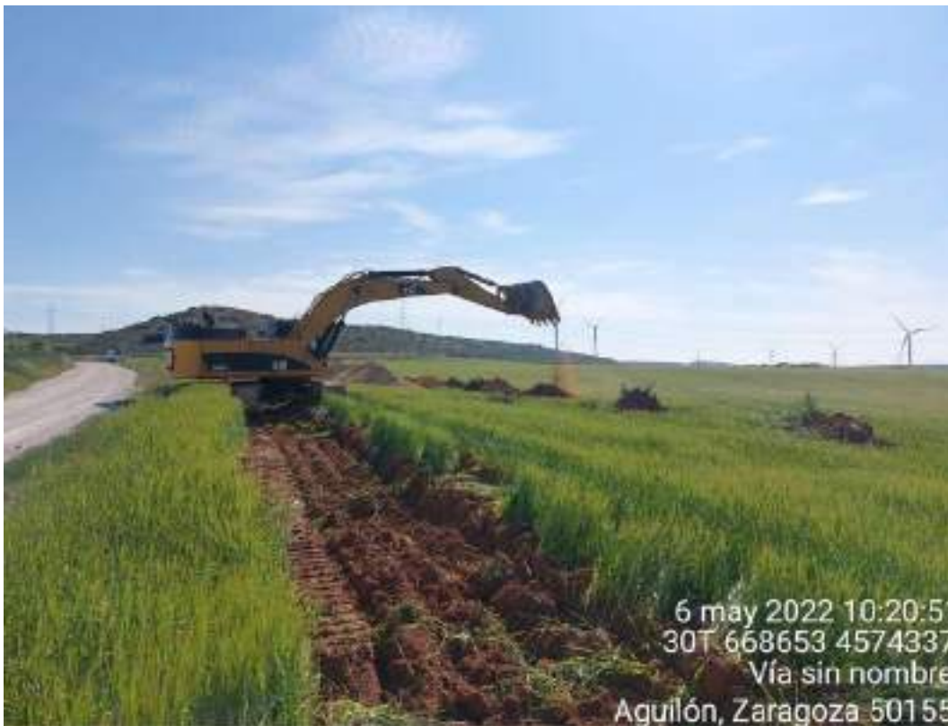
Ilustración 3. Correcta separación de la tierra vegetal en la zanja de la red de tensión.
