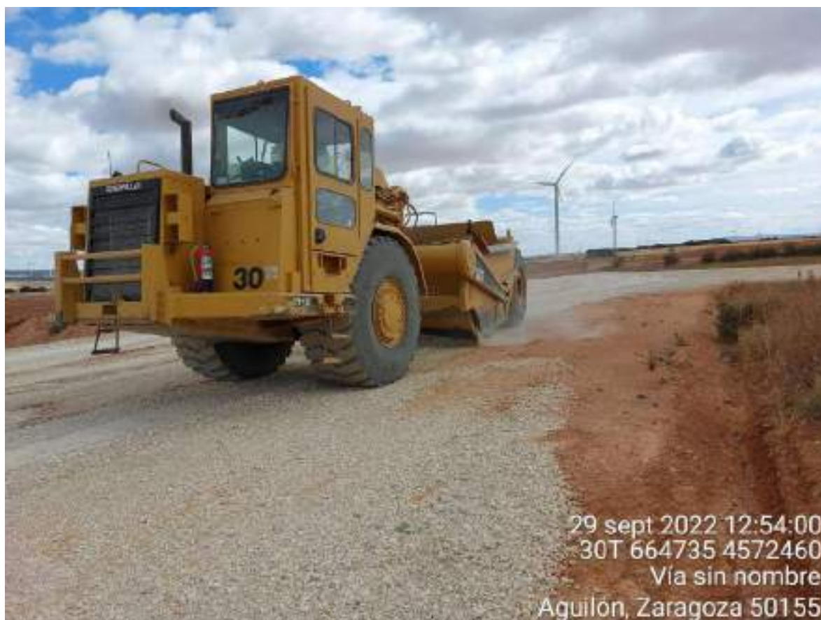
Imagen 2. Máquina quitando zahorra de la plataforma en el primer día de restauración ambiental de la obra en SBII-2.
