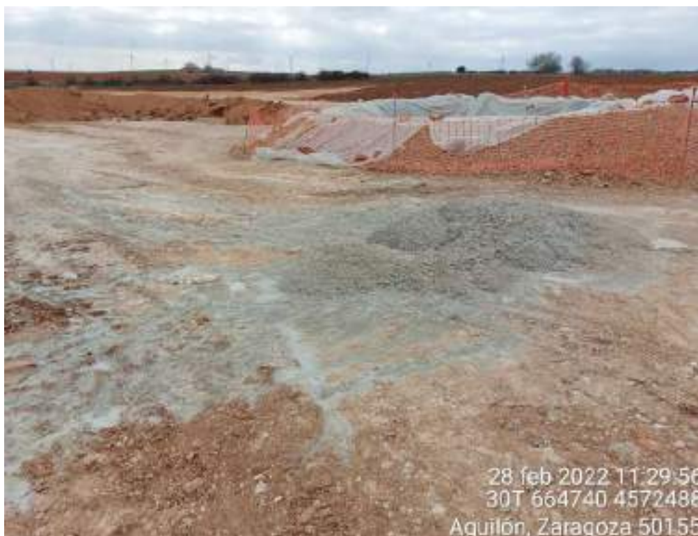
Imagen 1. No conformidad grave. Utilización de zonas de lavado junto con generación de residuo de hormigón pese a su prohibición.
