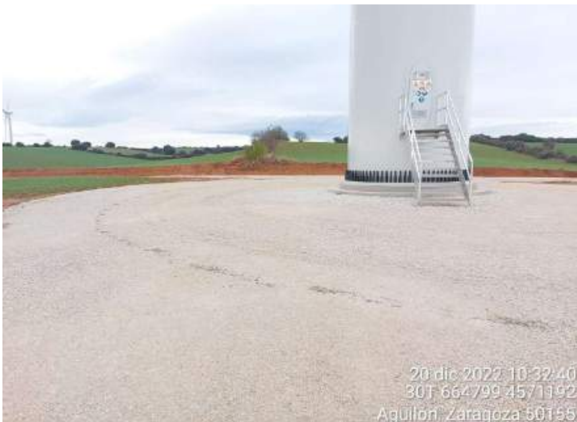
Imagen 2. Residuo de hormigón en SB2-04. Se debe retirar y gestionar adecuadamente.
