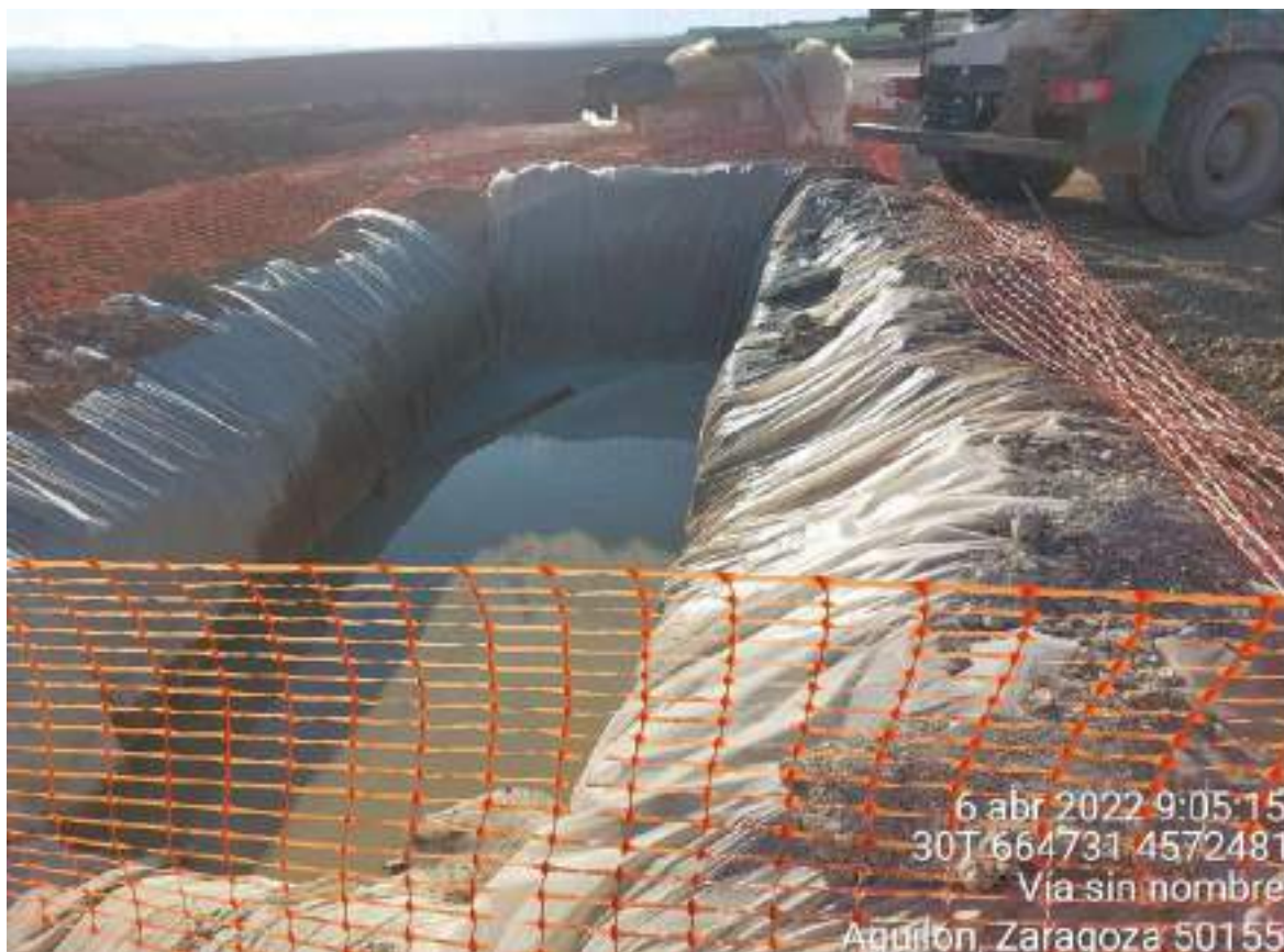
Imagen 4. Zona de lavado en perfecto estado tras lavado de cuba de hormigón en SBII-02.
