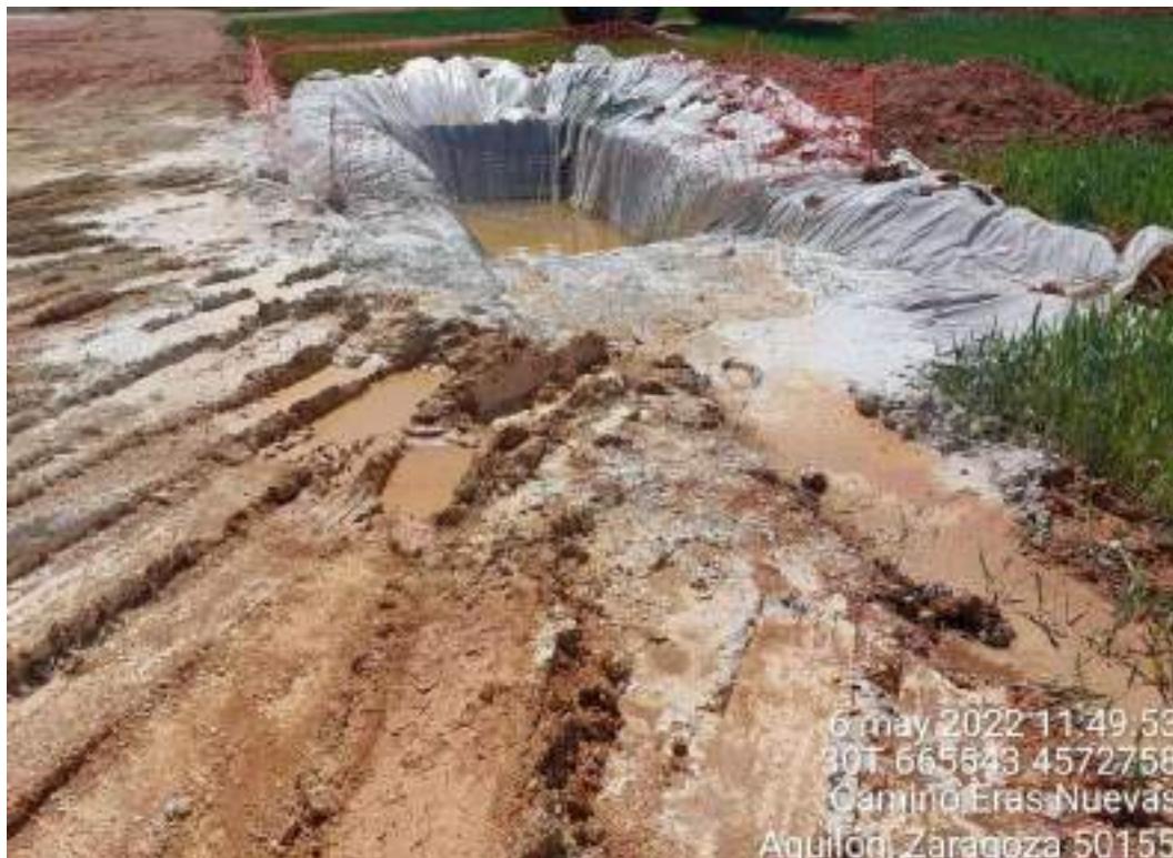
Ilustración 2. Pozo de lavado de SBI-7. Se consigue impermeabilizar el suelo del pozo, pero se contamina el suelo de la zona inmediata al pozo así como del cultivo. Se debe corregir y evitar situaciones así.
